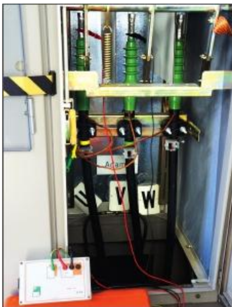
Einspeisung am Kabel
